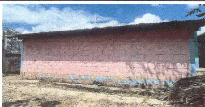
Foto 5: Repello en muro de cocina interior y exterior
